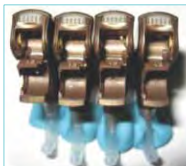
Figure 7 : Aucune corrosion n'a été observée au niveau du tiroir pile ni de la zone des contacts de l'Entrée
